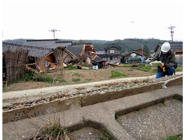
図 8. 背面盛土の押し出し（図 5 中 A 地点）
