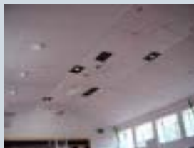
天井パネルの落下
