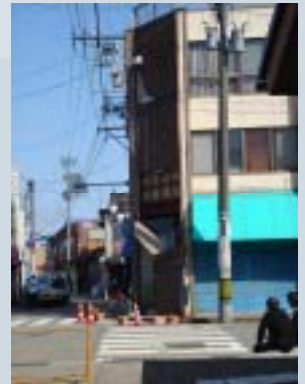
仕上げ材の剥落
