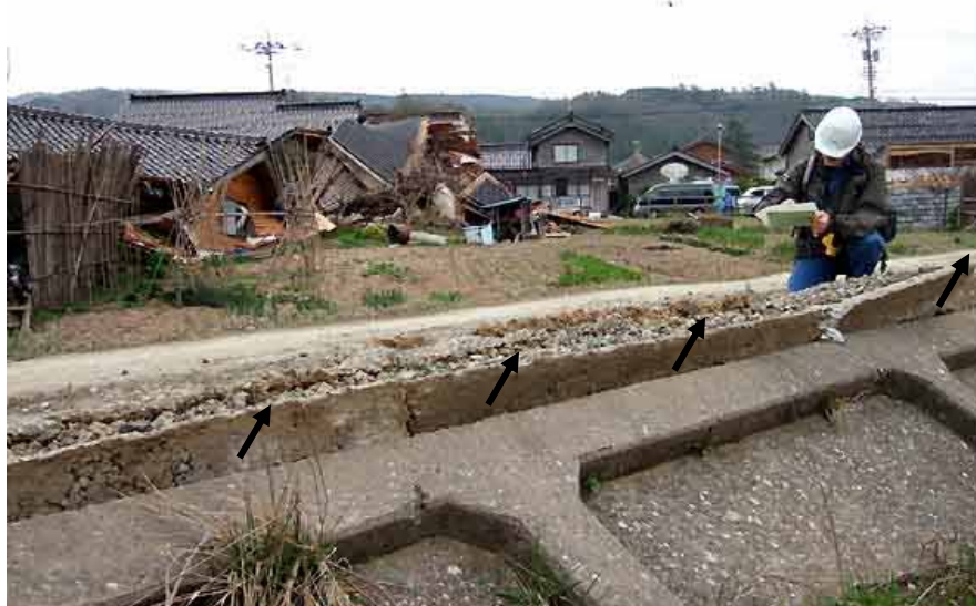
図9 背面盛土の押し出し
