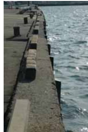
写真 7.3-2 七尾港矢田新町地区 岸壁法線のずれ
