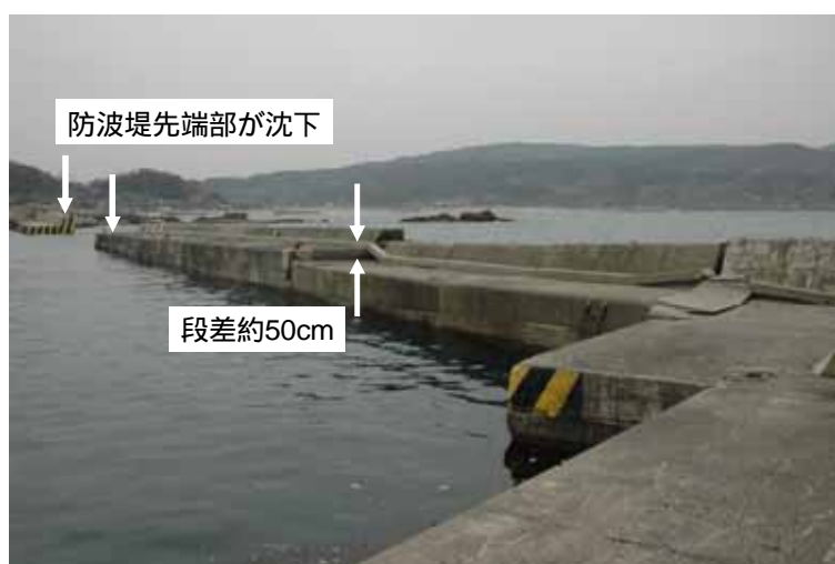
写真 7.4-2 鹿磯漁港 防波堤先端部の沈下
