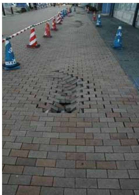
写真 7.6-1 七尾マリンパーク 被災状況
