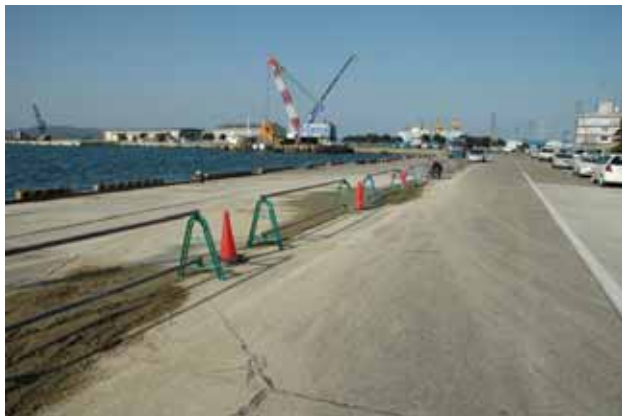
写真 7.3-1 七尾港矢田新町地区 物揚場 (-4m) 液状化による噴砂
