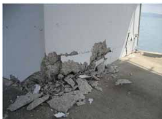
写真 6.1-2 橋脚基部ひび割れ
