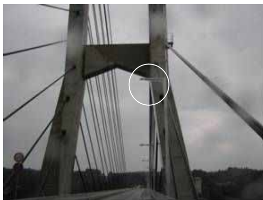
写真 6.1-4 照明柱の損傷
