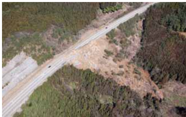
写真 5.9.1-1 NO.縦 - 38 被災後写真
