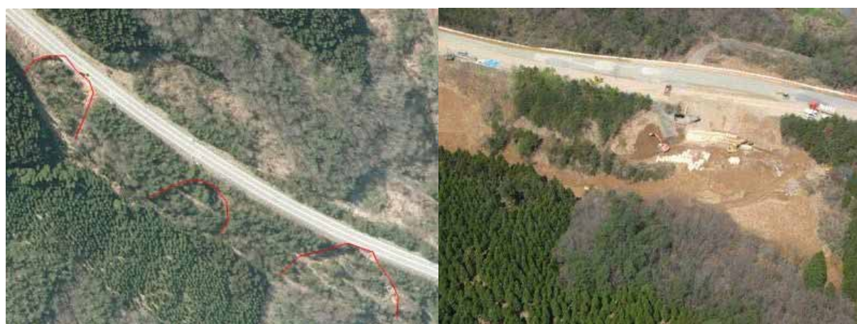
写真 5.10.1-1 NO.縦 - 39 被災後写真
