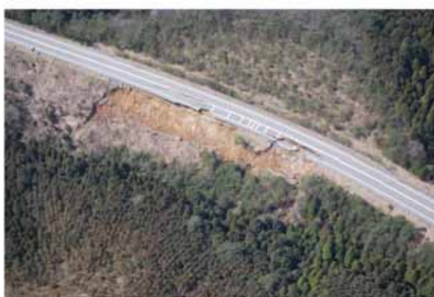
写真 5.7.1-1 NO.縦-26 被災後写真
