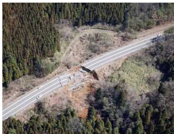
写真 5.5.1-1 NO.縦 - 14 被災後写真
