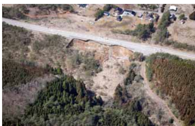
写真 5.13.1-1 NO.縦－41 被災後写真
