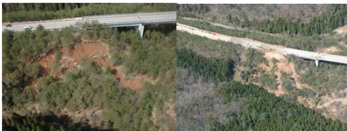
写真 5.14.1-1 NO.縦-43 被災後写真
