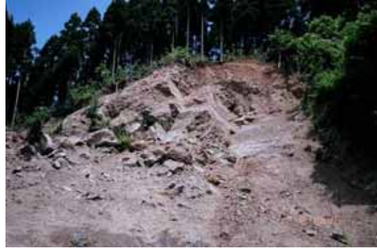
写真 4.1.7-2 くさび状に岩盤が崩落した上部
