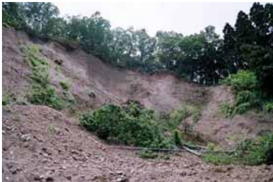
写真 4.2-3 滑落崖の崩落（S-35） 林野庁所管地すべり防止区域「尺ヶ池」 施工されていた法枠工も崩落
