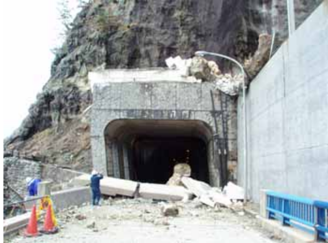
写真 4.1.5-2 崩落岩塊の一部による洞門の被災状況
