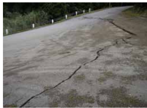
写真 4.4-2 震源近くの輪島市門前町広岡地区の地すべり内の道路盛土クラック。
