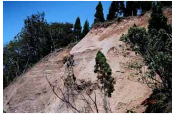
写真 4.1.3-11 滑落崖の状況
