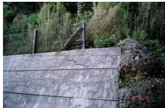
写真 4.1.3-15 一部が損傷した背後斜面の擁壁（S-31, コンクリート擁壁にクラック発生）
