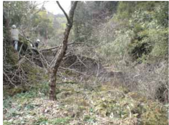
図 4.3-8 土石流を捕獲した治山ダム
