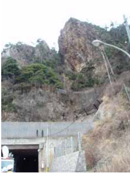
写真 4.1.5-1 洞門の右上の露岩部が崩壊発生位置
