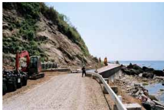
写真 4.1.3-4 崩土が取り除かれた市道
