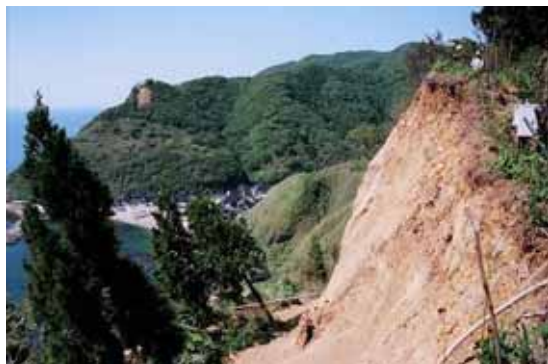
写真 4.1.3-9 深層崩壊の滑落崖
