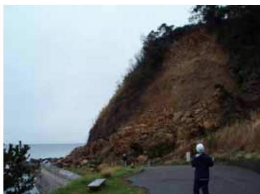
写真 4.1.4-1 海食崖の崩壊(S-9 地点)
