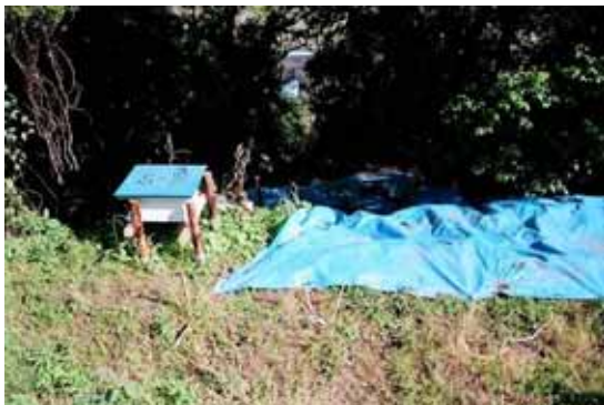
写真 4.1.3-14 応急対策が行なわれた背後斜面（S-31, 亀裂をシートで保護）
