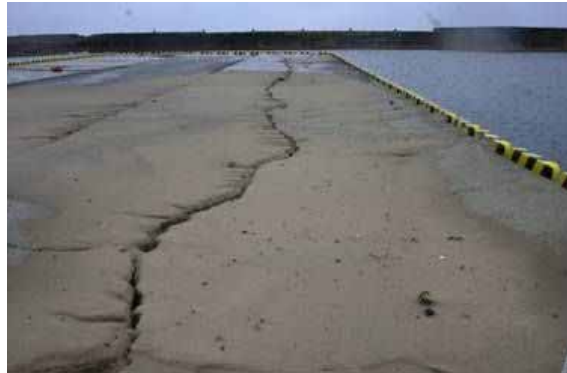
写真 3.3.2-1 エプロン部の亀裂と噴砂
