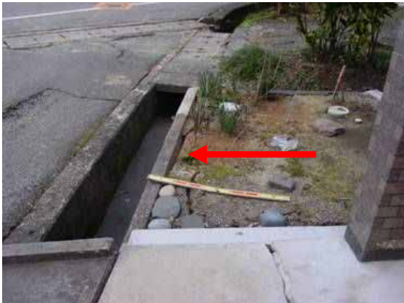
写真 3.5-3 地盤の側方流動
