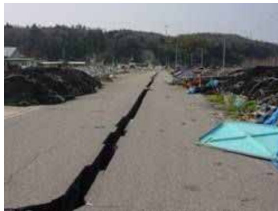
写真 3.3.1-1 護岸背後道路の亀裂
