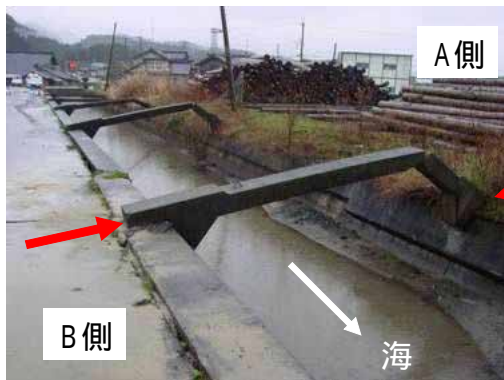
写真 3.7-1 支え構造の曲げ破壊
