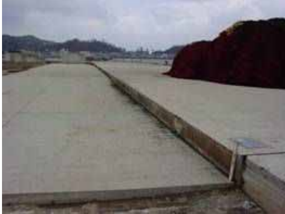
写真 3.3.2-5 エプロン部の沈下
