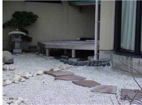
写真 3.6-2 建物周辺地盤の沈下
