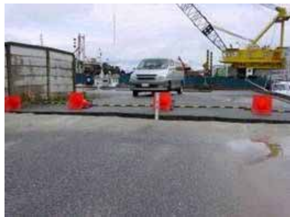
写真 3.3.4-2 道路の亀裂(地点 )
