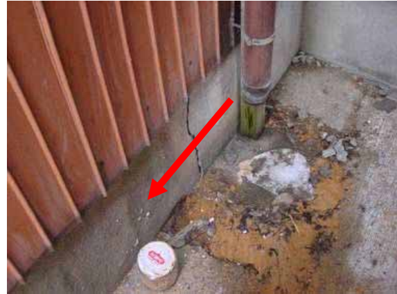
写真 3.5-2 基礎の引張亀裂
