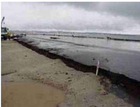
写真 3.3.4-1 エプロン部の沈下(地点 )
