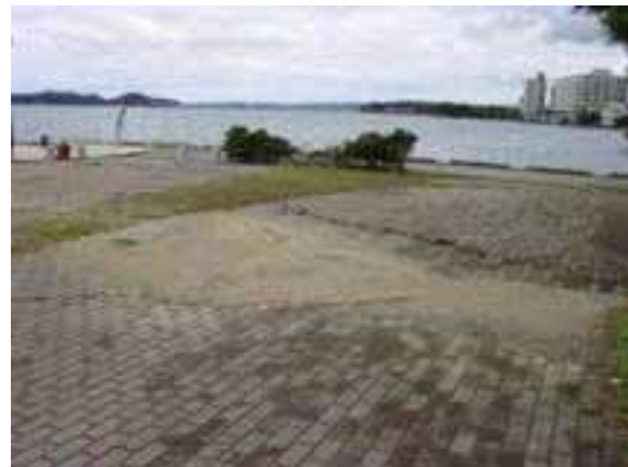
写真 3.3.4-4 インターロッキングの沈下(地点 )
