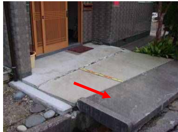
写真 3.5-4 土間コンクリートの引張亀裂
