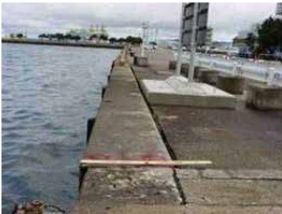
写真 3.3.4-3 岸壁のはらみ出し(地点 )
