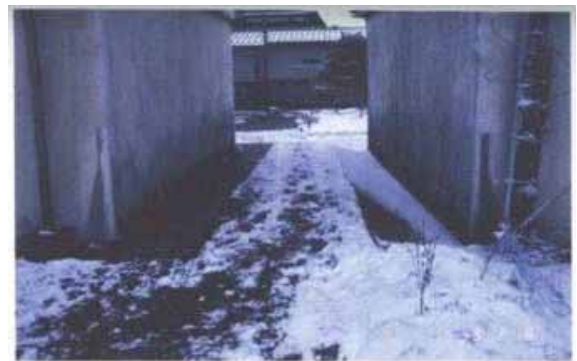
写真20 市営住宅の沈下（正院町正院）
