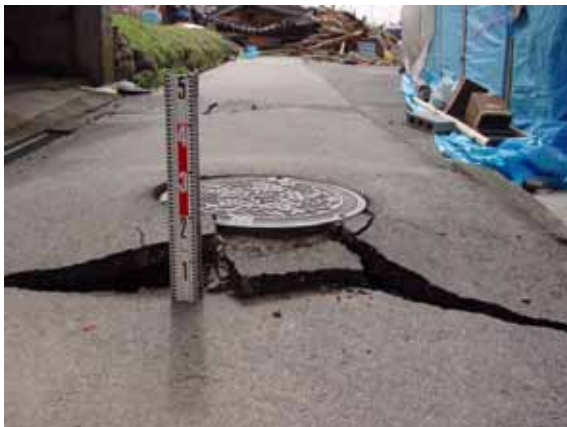
写真 3.4-1 マンホールの浮上
