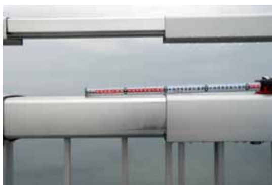
写真 1.4.2-3 中能登農道橋に見られる橋軸方向（東西方向）の振動痕
