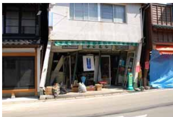
写真 11-6 建物被害例（輪島市門前町門前）
