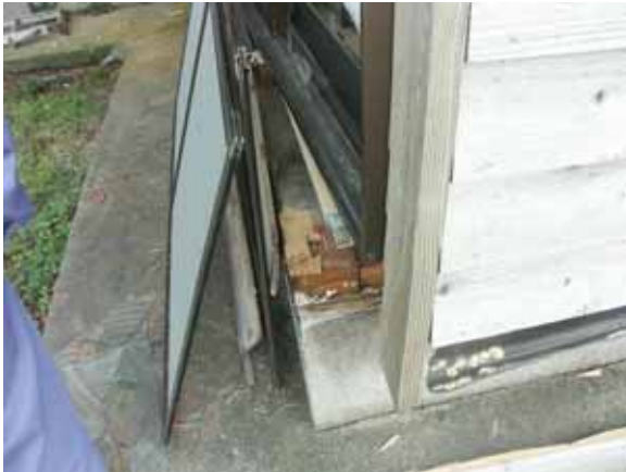
写真 11-13 建物下部被害例(輪島市門前町道下)
