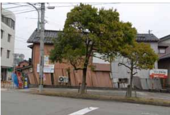
写真 11-17 建物被害例(穴水町大町)
