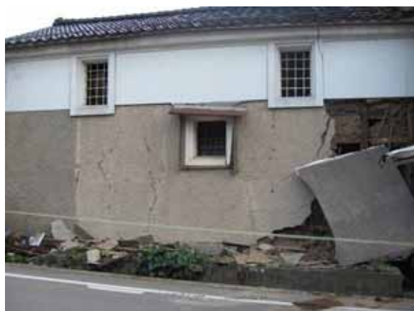
写真 11-3 土蔵被害例（輪島市鳳至町）
