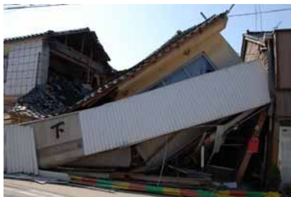
写真 11-4 建物倒壊例（輪島市門前町門前）
