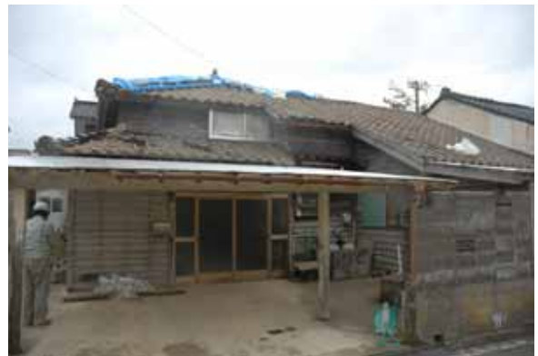
写真 11-16 建物被害例(輪島市門前町鹿磯)
