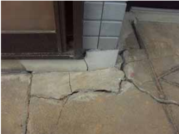
写真 11-15 建物基礎被害例(輪島市門前町道下)
