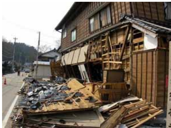
写真 11-8 建物被害例（輪島市門前町清水）
