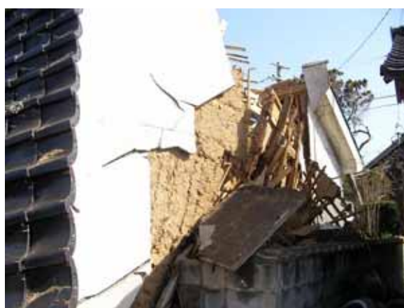
写真 11-12 土蔵被害例（輪島市門前町道下）
