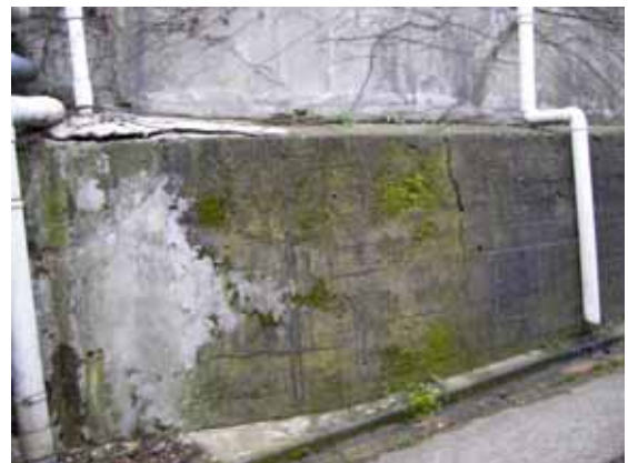
写真10.2-2 現場打ちL型擁壁：コーナー部 (擁壁の施工不良、老朽化)
