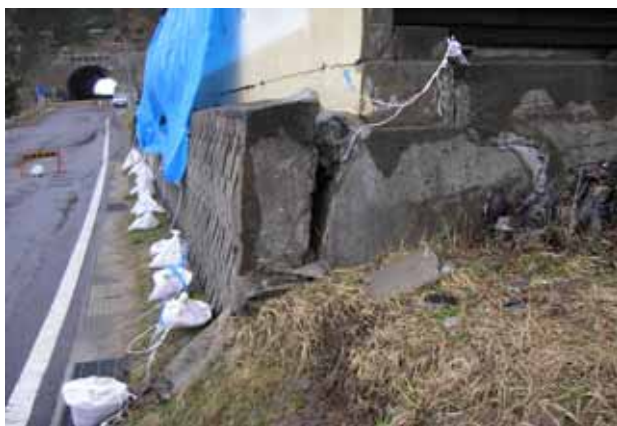
写真10.2-5 鹿磯港：練石積擁壁の倒壊
