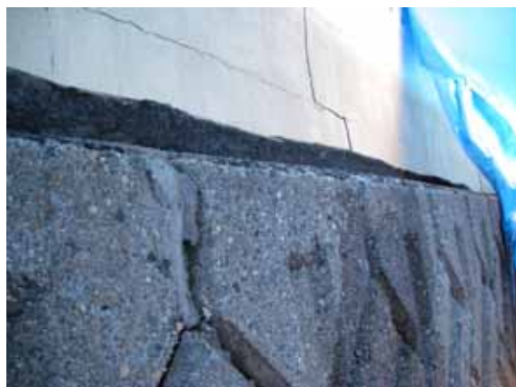
写真10.2-6 鹿磯港：練石積擁壁の横クラック
