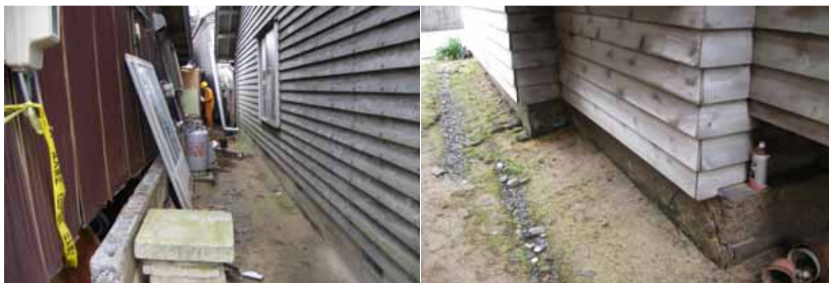
写真10.4.1-2 コンクリートブロック基礎の崩壊
