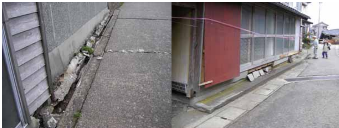
写真10.4.1-1 建物基礎部コンクリートの破壊
