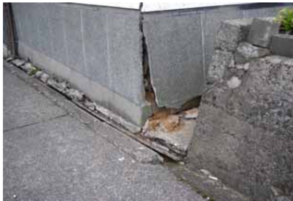
写真10.2-4 建物基礎コンクリート：コーナー部 コンクリート断面の不足
