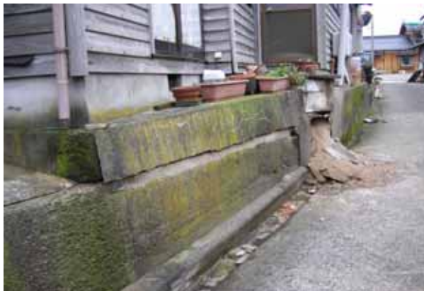
写真 10.2-3 現場打ち L 字形擁壁の亀裂
