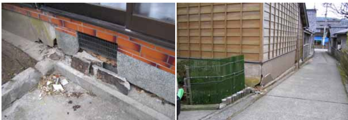
写真10.4.1-3 建物基礎の崩壊 (基礎の部分の木材が腐っているため)
