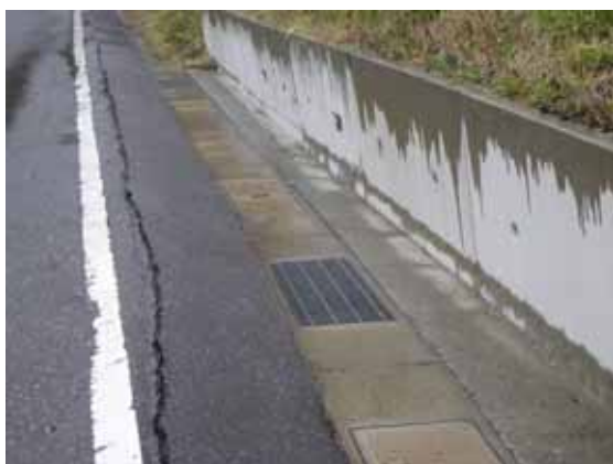
写真10.2-7 鹿磯港：プレキャスト L 型擁壁の傾斜
