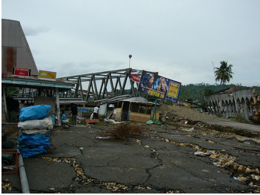
写真-14 ニアス島グヌンシトリで液状化で被害を受けた橋梁
