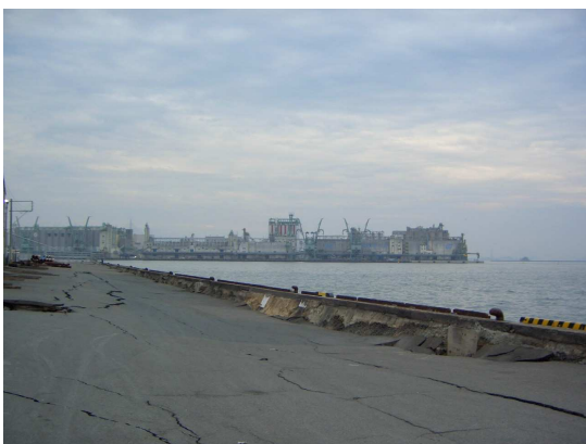
写真 4.9 中央埠頭 7 号岸壁の被害状況
