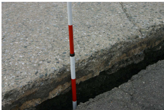
写真 4.13 箱崎埠頭 6 号岸壁の段差
