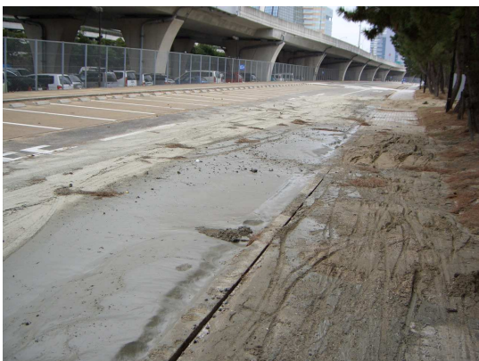
写真 4.3 ヤフードーム裏シーサイドもち海浜公園駐車場での噴砂跡
