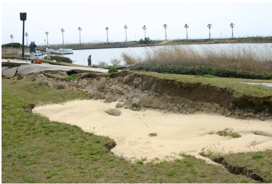
写真 4.8 海の中道公園内での噴砂跡
