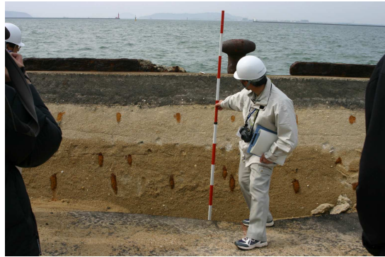
写真 4.10 中央埠頭 7 号岸壁の被害状況
