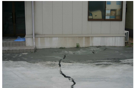
写真 4.6 中央埠頭 7 号岸壁の背後での噴砂跡
