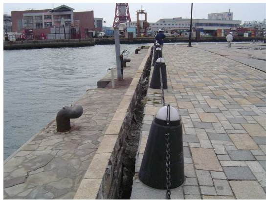
写真 4.11 中央埠頭イベントバースの被害状況
