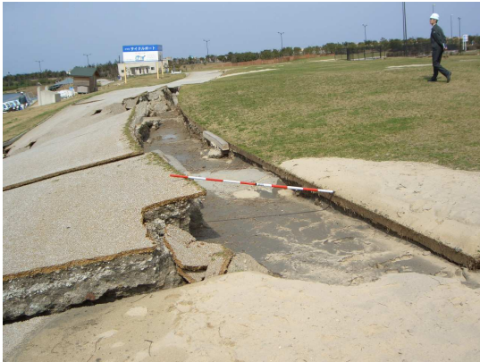
写真 4.19 海の中道海浜公園（光と風の広場）内での地盤の流動
