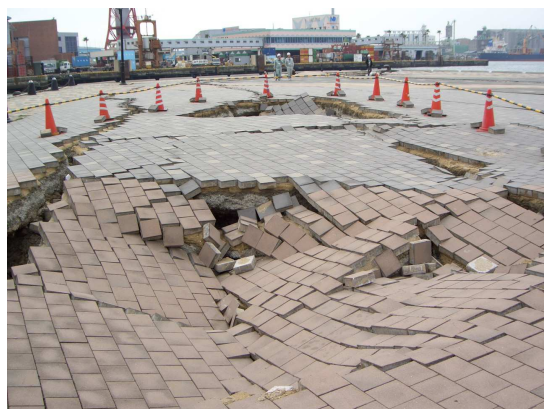
写真 4.12 中央埠頭イベントバースの被害状況
