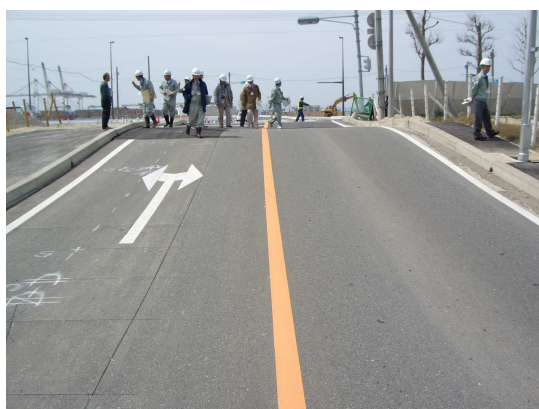
写真 4.17 アイランドシティ 1 号線交差点での道路の隆起
