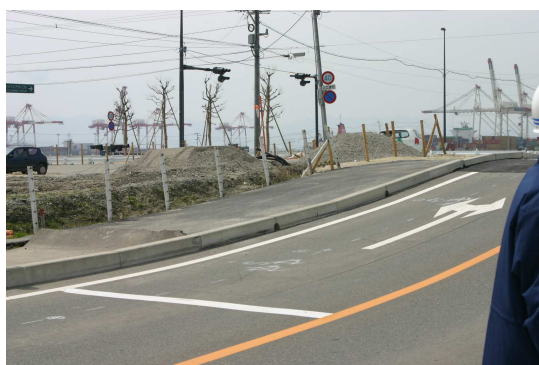
写真 4.18 アイランドシティ 1 号線交差点での道路の隆起
