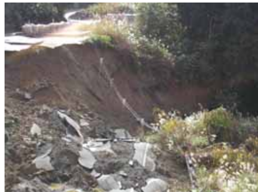
写真 2 北側の崩壊箇所（南方向を望む）
