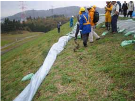
(下流側のり面で天端直下のクラック)
