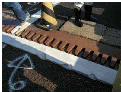
写真 5 ジョイント部の段差
