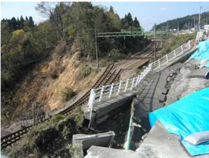
11 月 7 日時点での被災状況
