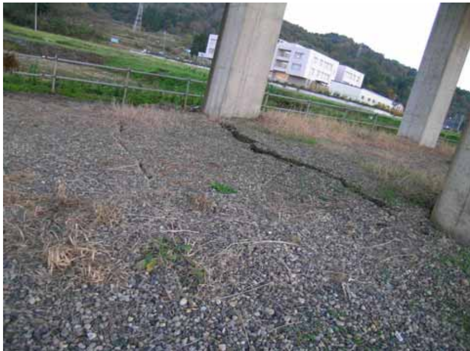
写真 5 地表面部に発生した亀裂
