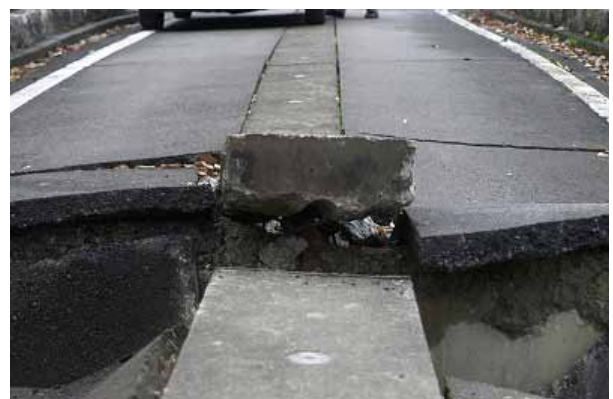
写真 13 左図の接近写真。パイプが破断
