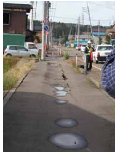
写真2 埋め戻し部の沈下
