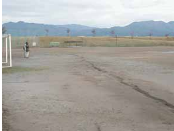
写真 1 河川公園グラウンドの発生した連続亀裂と噴砂跡
