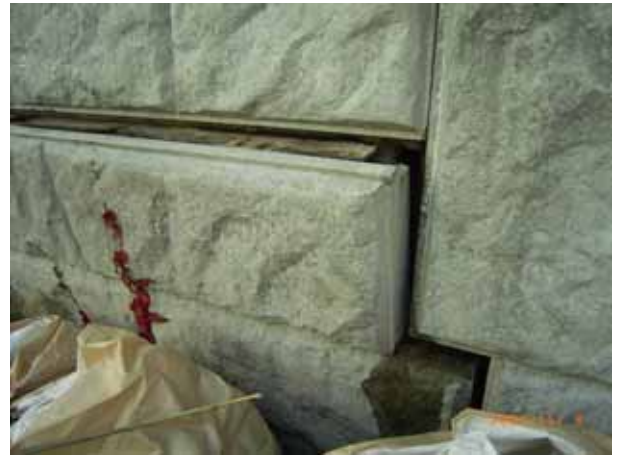
写真 2 壁面からの湧水
