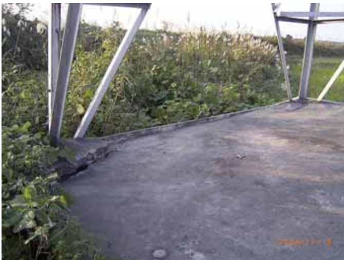
写真 5 送電鉄塔基礎上板の沈下
