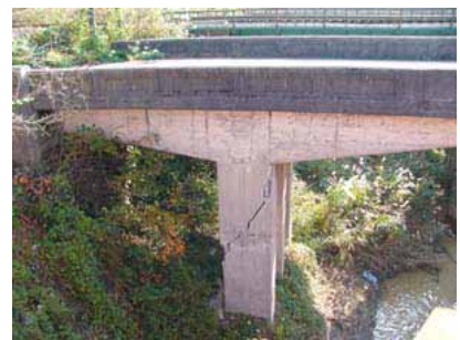
写真 6 旧道路橋の損傷
