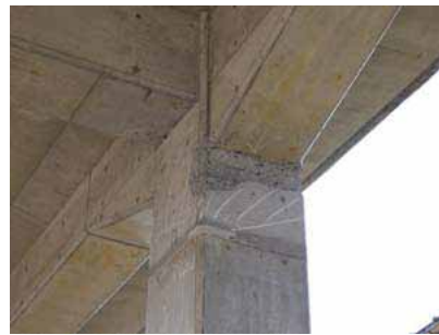
写真 2 橋脚上部の塑性ヒンジ
