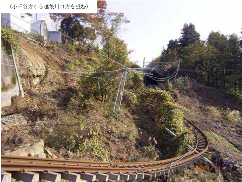
写真 6 220km500m 付近の被害状況(その 1)
