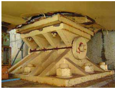
写真 2 支承周辺の損傷
