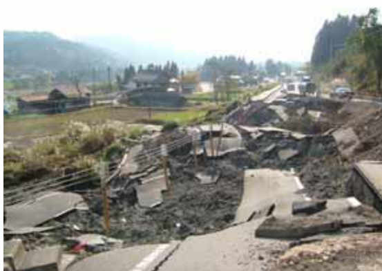
写真 3 盛土崩壊箇所 2 の状況(川西町方向)
