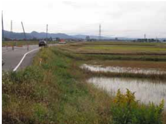
写真 4 陥没した道路側方の状況
