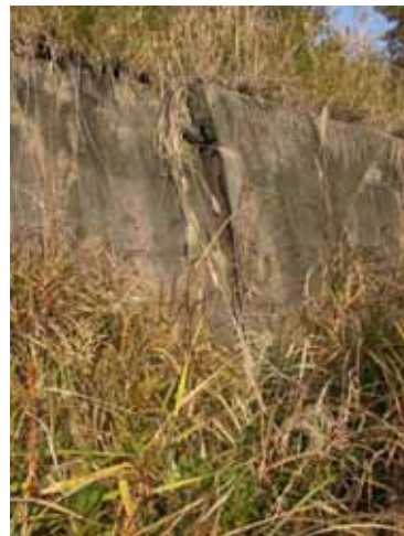
写真10 高町4丁目付近の外周擁壁の 変位
