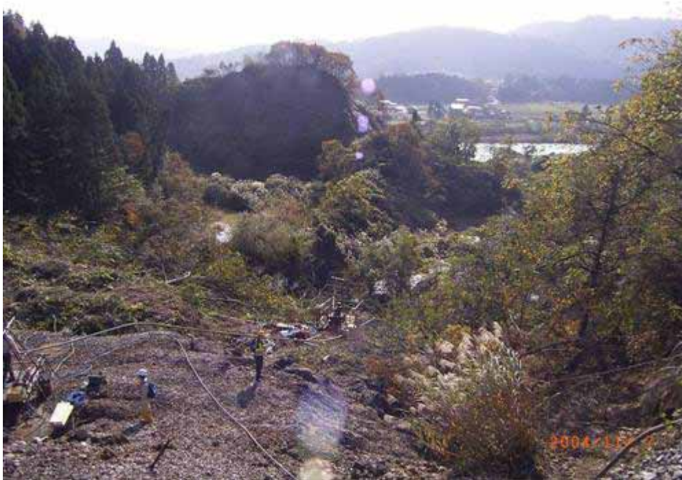
写真 4 盛土崩壊地の地形(220km900m 付近：写真奥に信濃川が見える。崩壊盛土した盛土は信濃川右岸の沢地形の斜面上に建設されたものであったことが分かる)
