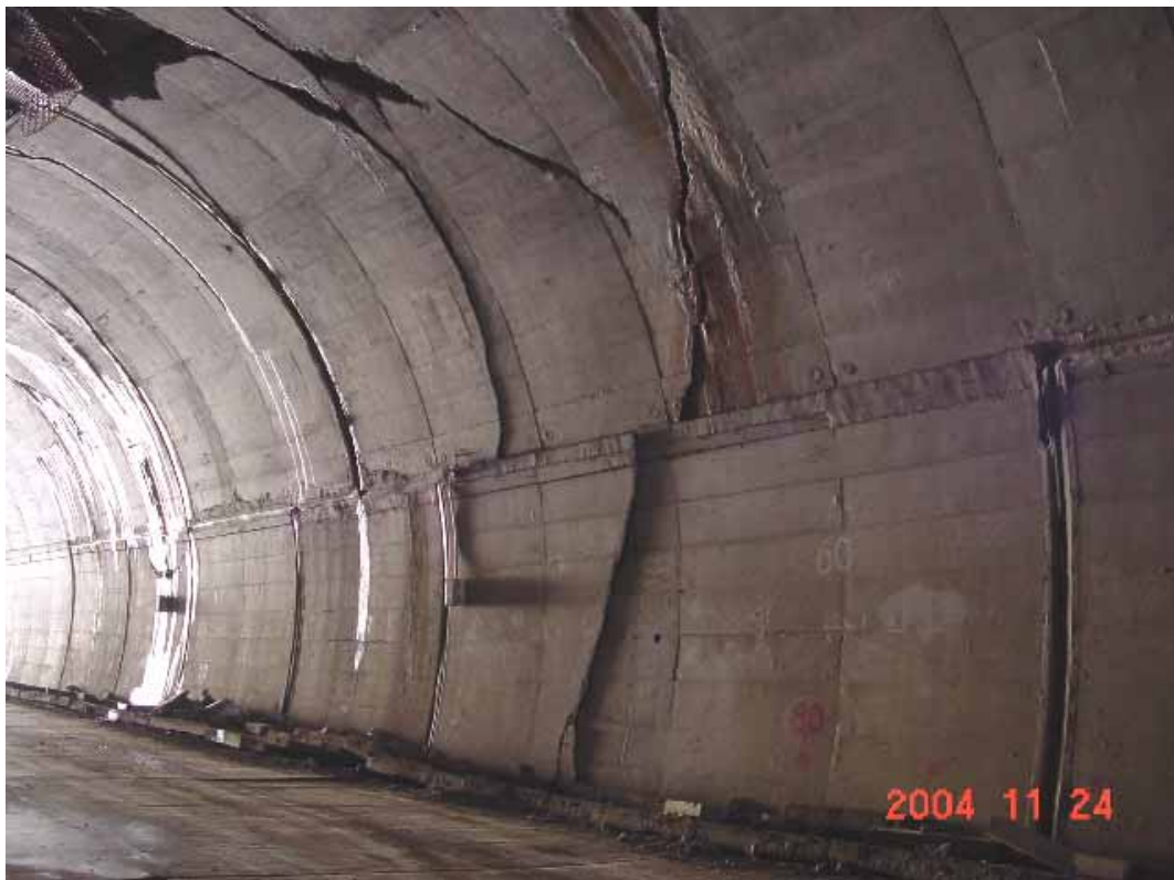
写真-1 荒谷トンネル北側坑口付近東側側壁およびアーチコンクリートの被害状況 （写真：森伸一郎撮影）
