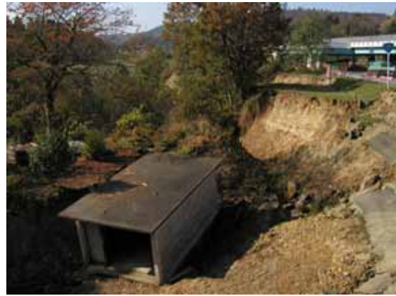
写真 2 塩殿 A での斜面崩壊(全体像：拡大)
