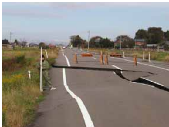
写真 3 水田内を走る道路の陥没
