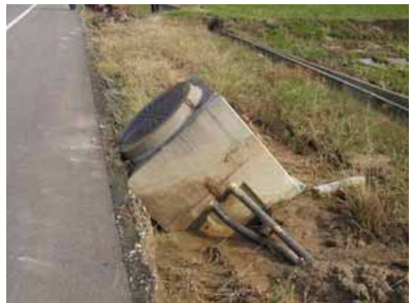
写真 4 浮き上がって転倒したマンホール
