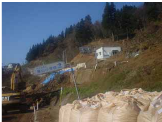
写真 2 中山の深層崩壊（近景）
