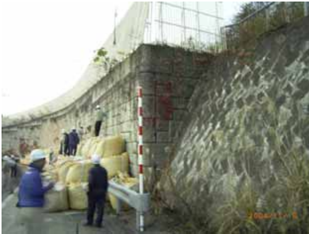
写真 1 補強土擁壁のはらみ出し
