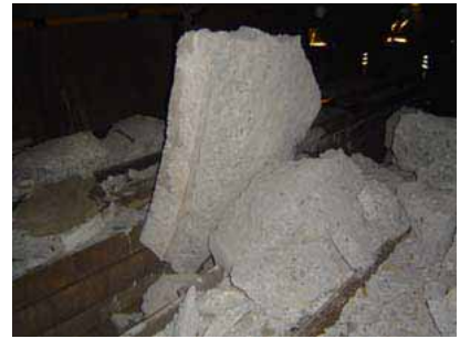
写真3 剥落したコンクリート
