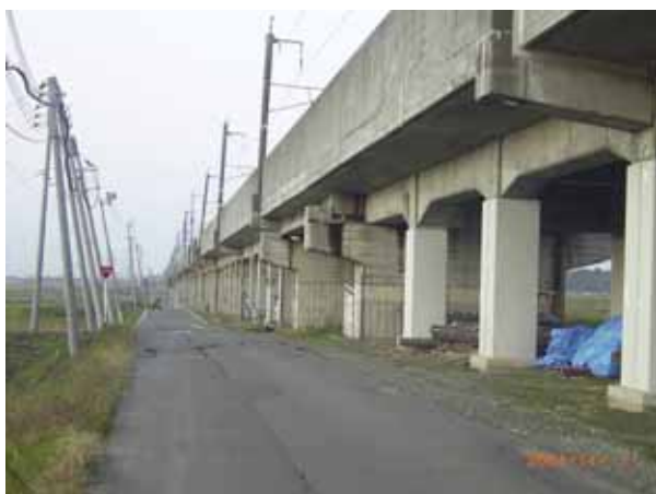
写真 2 側道表面の状況
