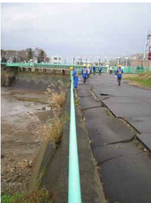
(貯水槽擁壁の傾斜)
