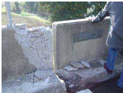
写真 4 高欄の損傷状況
