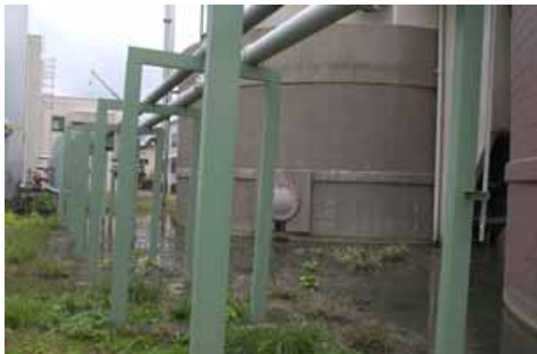
写真 10 汚泥消化槽からの漏出
