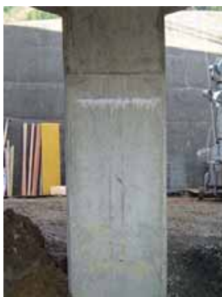
写真 2 隣接柱の状況
