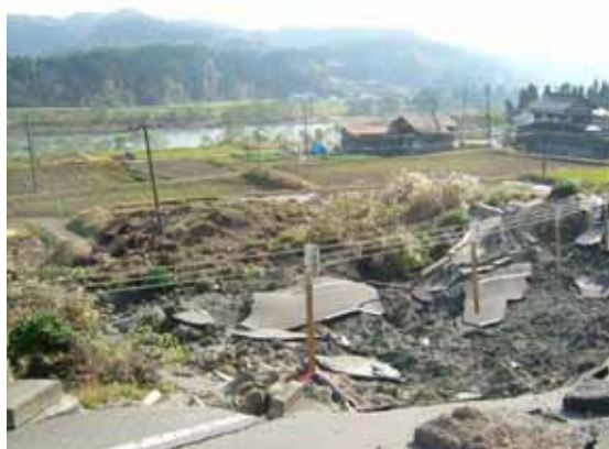
写真 4 盛土崩壊箇所 2 の状況(崩壊状態)
