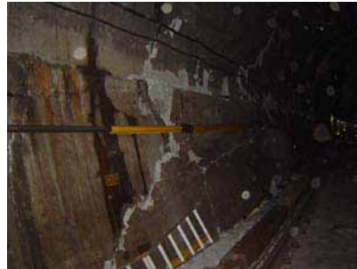
写真5 側壁部の損傷
