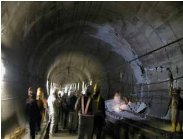
写真 1 トンネル覆工の崩落
