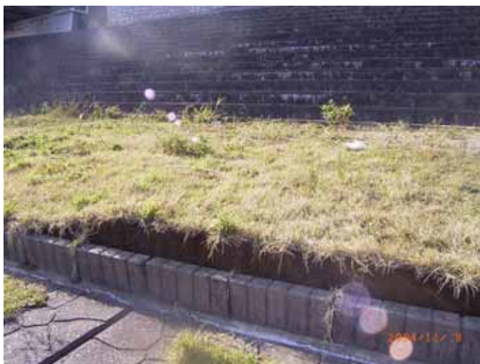
写真 1 小段部で生じた段差
