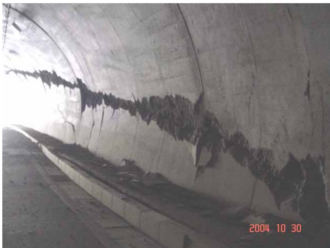
写真-1 木沢トンネル北側坑口付近東側の被害状況 （写真：森伸一郎撮影）
