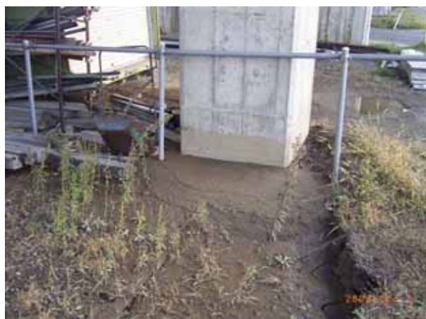
写真 3 基礎の埋め戻し部の沈下
