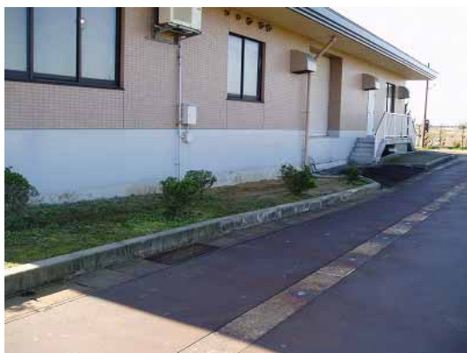
写真 3 建物裾部に以前の地表位置が残る
