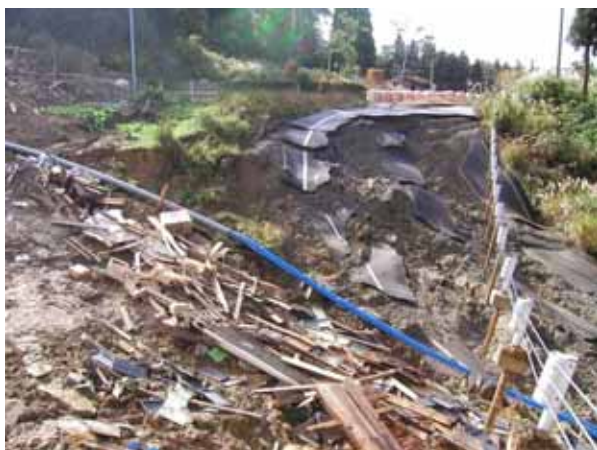
写真 5 南側の崩壊箇所
