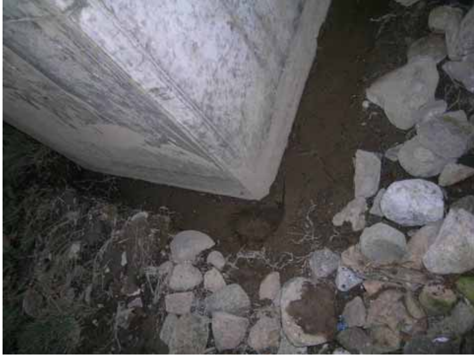
写真 4 橋脚基部における液状化痕
