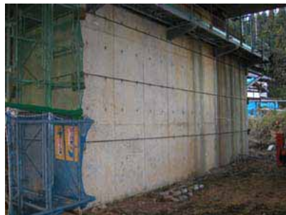
写真 4 壁状橋脚のひび割れ
