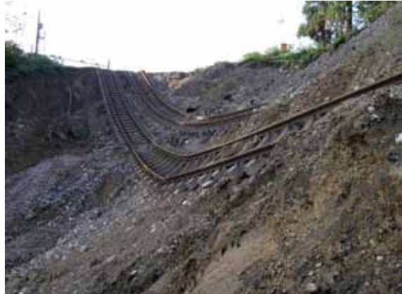
（崩壊盛土下側から小千谷方を望む）
