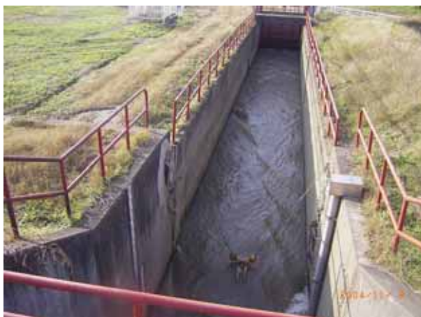
写真 3 樋門の堤内地側水路の破損
