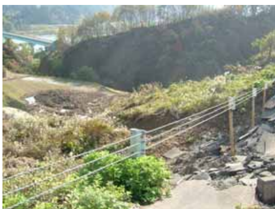
写真 1 盛土崩壊箇所 1 の状況(川西町方向)
