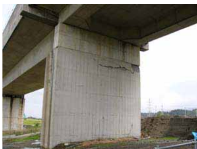
写真 1 壁式橋脚パラペット 部下端付近の曲げ損傷
