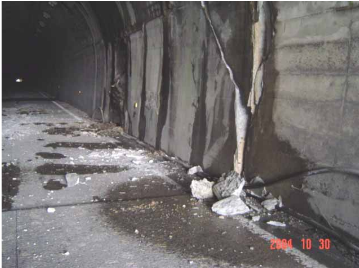
写真-1 羽黒トンネル西側坑口付近南側側壁の被害状況 (写真：森伸一郎撮影)
