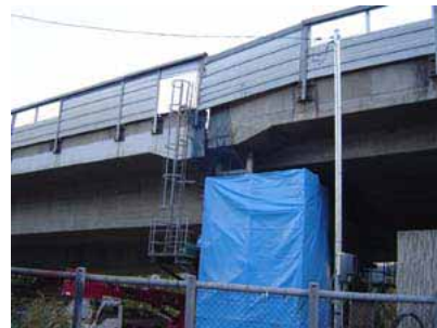
写真 5 上部工の損傷状況
