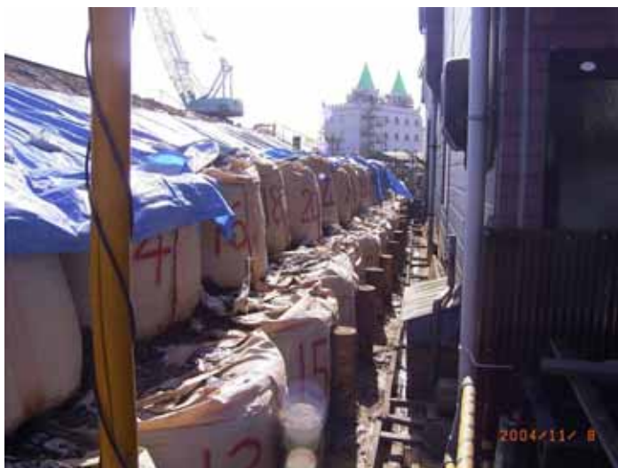
写真 5 写真 4 ののり尻付近の詳細
