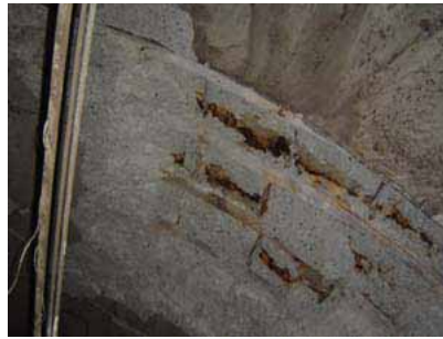
写真2 覆工上部の損傷
