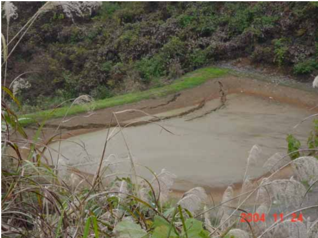
写真-2 荒谷トンネルより斜め上部にある池の堤体の円弧すべり前のテンションクラック
