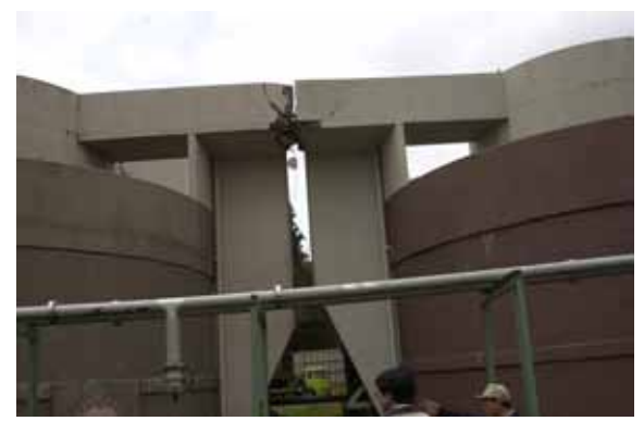
写真 11 汚泥消化槽連結部の破断
