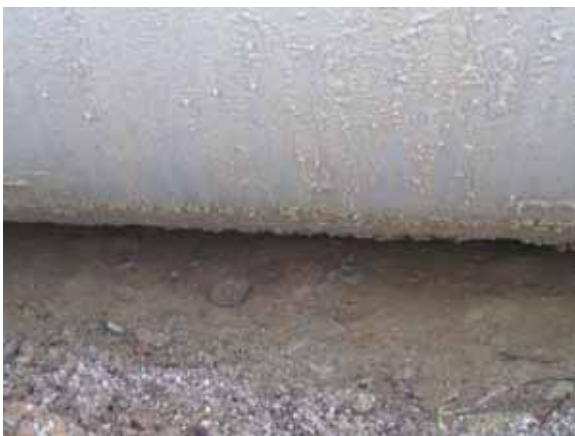
写真 3 埋設管の下に空隙
