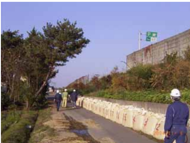
写真 3 腰土留めの傾斜（写真 1 とは反対側）
