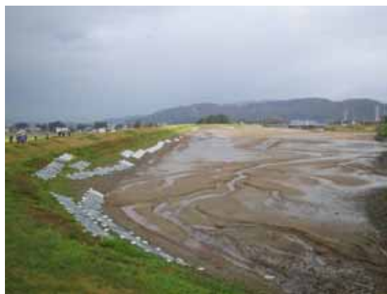
(貯水池側のり面でのクラック)
