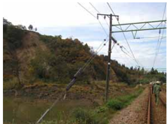
写真 4 北側の崩壊箇所
