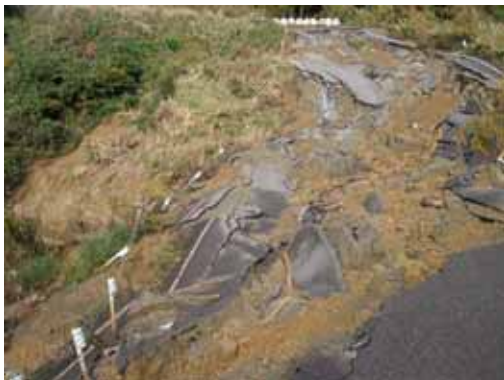
写真 1 北側の崩壊箇所（北方向を望む）
