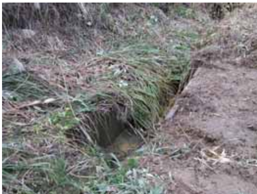
写真 3 沢部からの排水工
