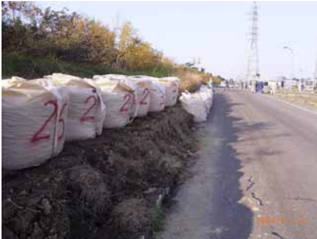
写真 1 腰土留めの転倒
