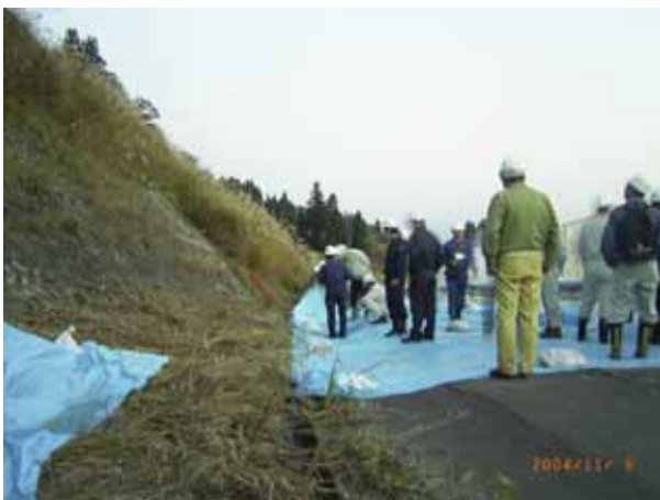
写真 3 背面地盤上の段差（右側が補強土擁壁）
