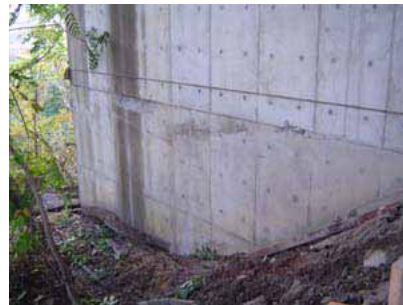
写真 2 打継部の損傷状況
