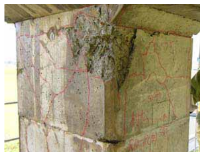
写真 3 材端部の曲げ塑性ヒンジ
