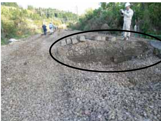
写真 5 ボックスカルバート背面の沈下
