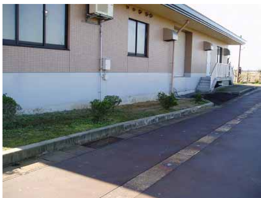
写真3 建物裾部に以前の地表位置が残る
