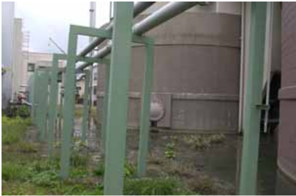
写真 10 汚泥消化槽からの漏出
