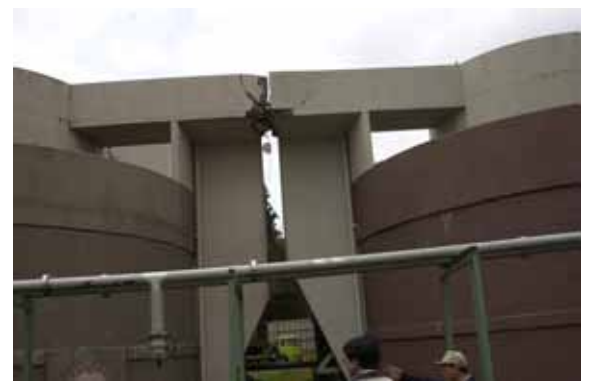
写真 11 汚泥消化槽連結部の破断
