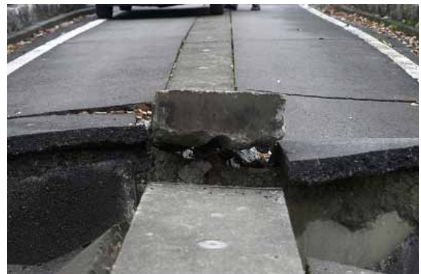
写真 13 左図の接近写真。パイプが破断
