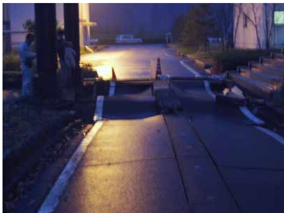
写真 12 管理棟車寄せ。中央縦線は消雪パイプ
