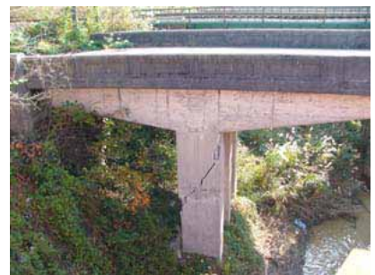
写真 6 旧道路橋の損傷
