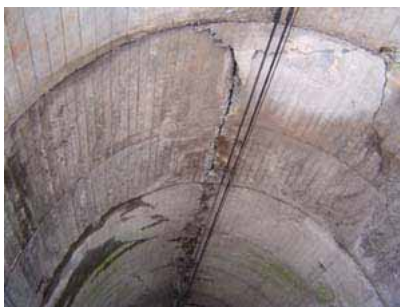
写真 4 クラウン部の損傷
