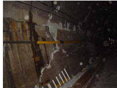
写真5 側壁部の損傷
