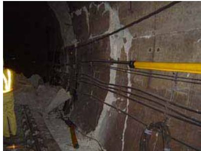
写真4 側壁部の損傷
