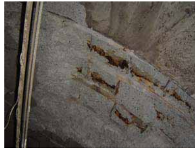
写真2 覆工上部の損傷
