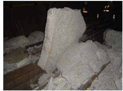
写真3 剥落したコンクリート
