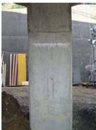
写真2 隣接柱の状況
