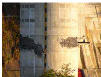
写真6 段落し部の状況
