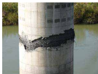
写真5 段落し部の状況
