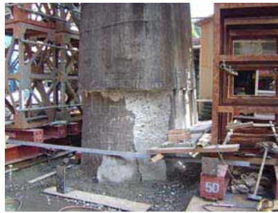
写真 2 橋脚の損傷状況
