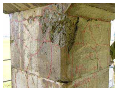
写真3 材端部の曲げ塑性ヒンジ
