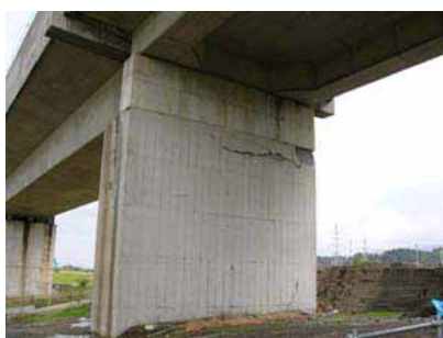
写真1 壁式橋脚パラペット 部下端付近の曲げ損傷
