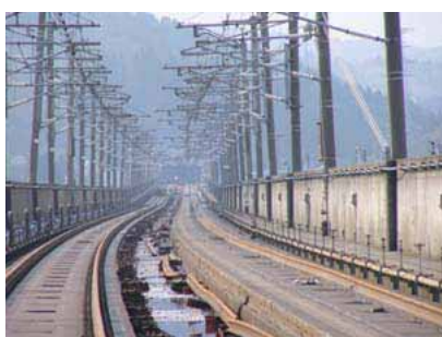
写真1 レールの損傷状況
