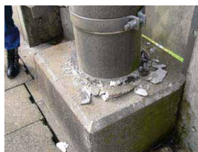
写真3 電柱基部の緩衝装置
