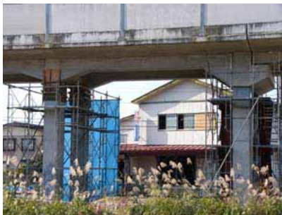
写真1 被災・補修状況
