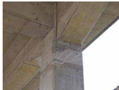
写真2 橋脚上部の塑性ヒンジ
