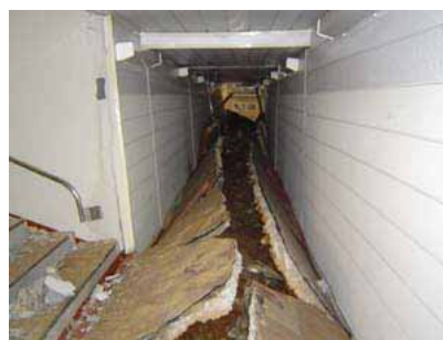
写真 3 地下通路の損傷状況
