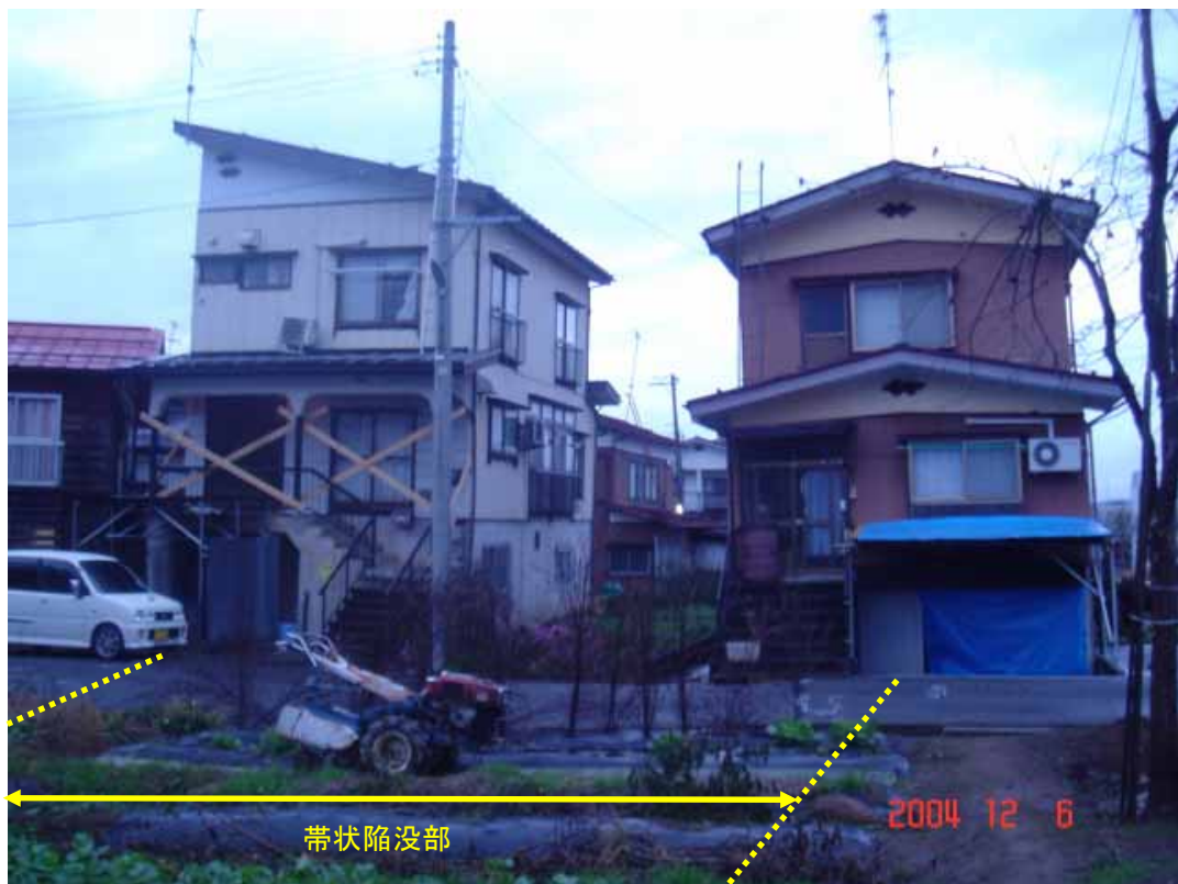
写真-2 带状陥没部を跨ぎ向かい合って傾斜した2棟の家屋(十日町市美雪町2丁目)
