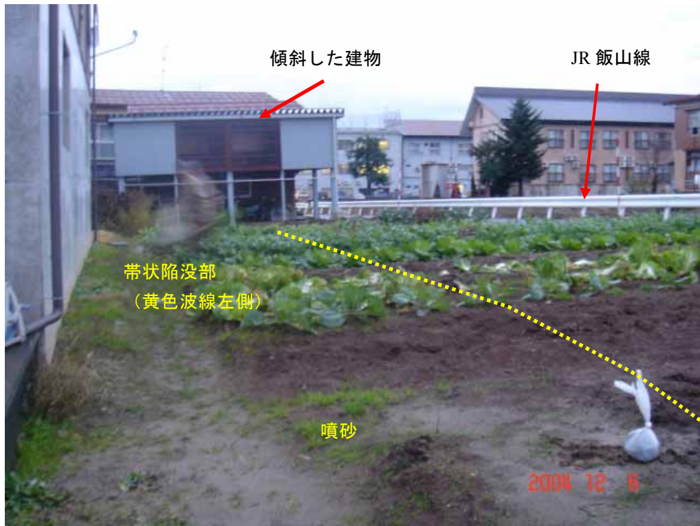
写真-1 带状陥没部を跨ぐ傾斜した建物と陥没部内噴砂(十日町市美雪町3丁目)
