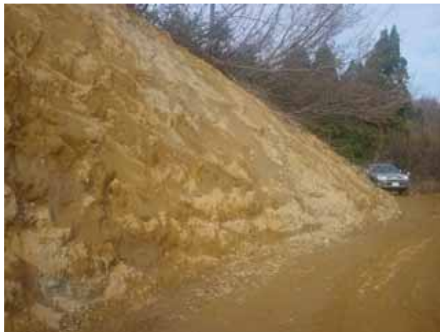
写真 2 木籠付近の表層崩壊（風化した砂岩）
