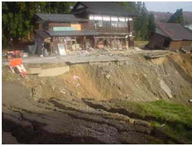
写真 1 池谷地区の表層崩壊と被災した住宅
