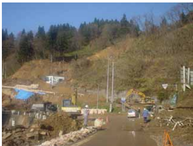
写真1 中山の深層崩壊（遠景）
