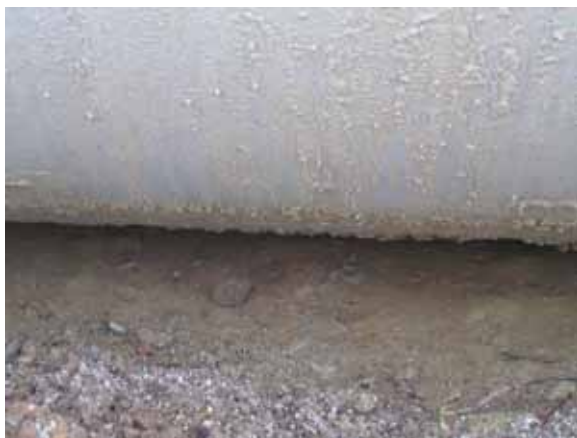
写真 3 埋設管の下の空隙
