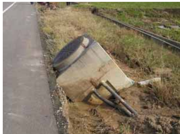
写真 4 浮き上がって転倒したマンホール
