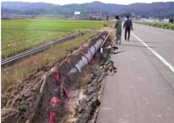
写真 1 浮き上がった埋設管
