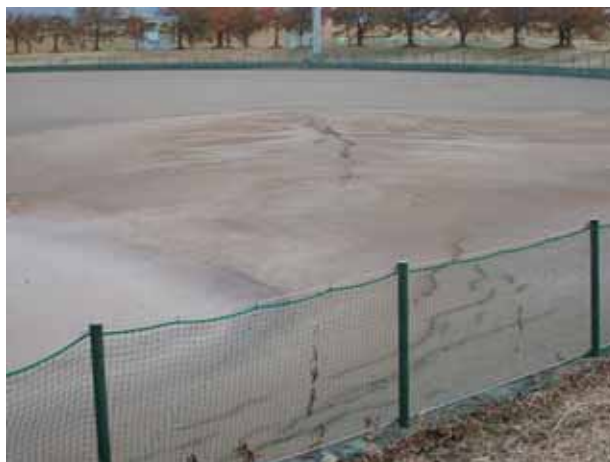
写真2 野球場に発生した亀裂と噴砂跡
