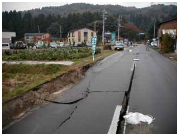
写真2 埋め戻し土の液状化による道路面の沈下（写真1のマンホールから新幹線と反対方向に見る）
