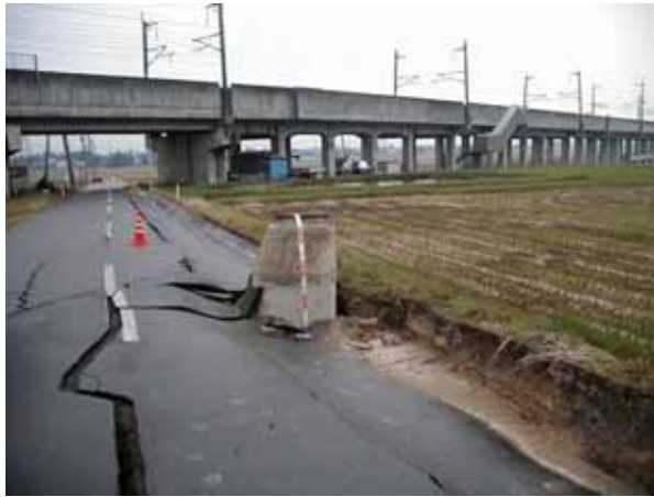
写真1 埋め戻し土の液状化によるマンホールの浮き上がり（新幹線脱線現場付近）
