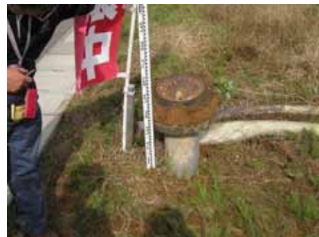
写真6 住宅分譲地内での排水枡の浮き上がり
