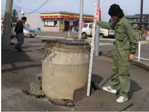
写真1 小千谷市桜町交差点マンホールの浮き上がり
