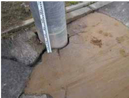
写真3 電柱基部からの噴砂
