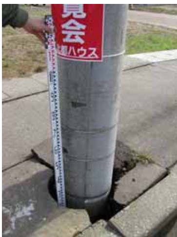
写真5 住宅分譲地内での電柱の沈下
