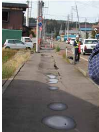
写真2 埋め戻し部の沈下
