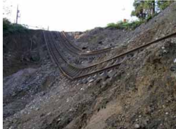
（崩壊盛土下側から小千谷方を望む）
