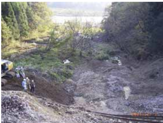
写真 2 崩壊した盛土下方の状況
