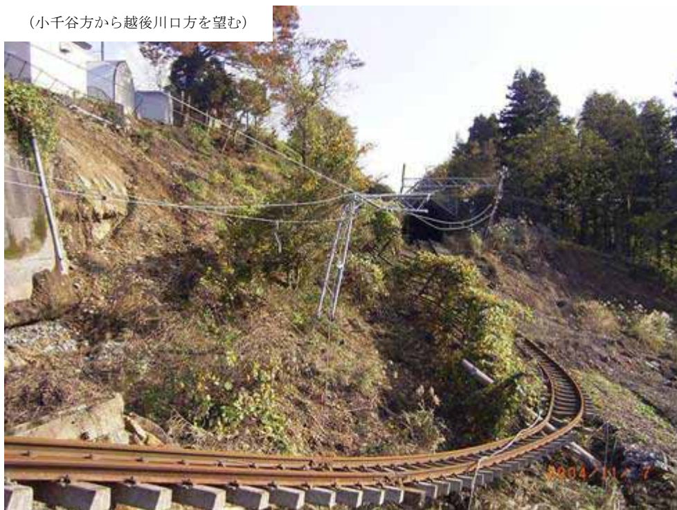
写真 6 220km500m 付近の被害状況(その 1)
