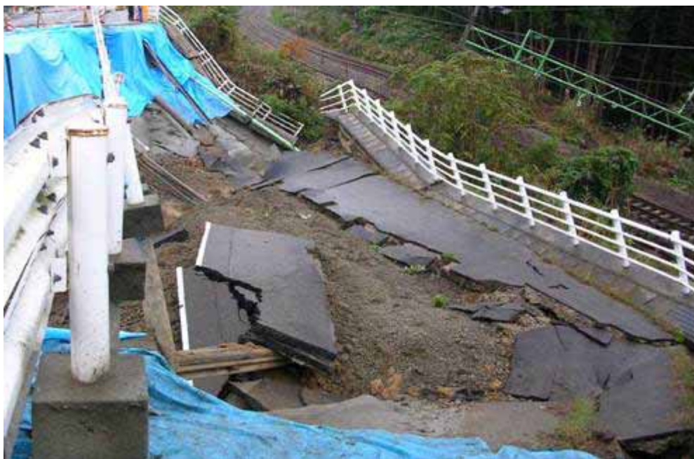
写真 3 国道 17 号線の崩壊擁壁の上から上越線を望む(220km900m 付近)
