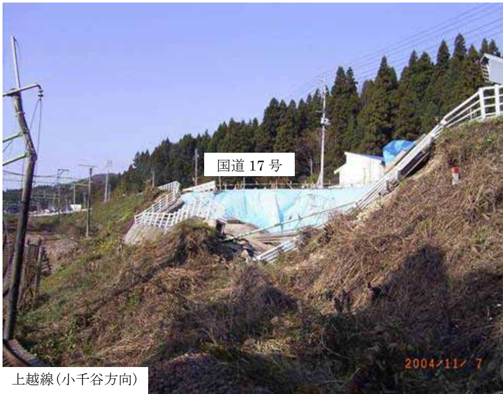
写真 2 上越線に隣接する国道 17 号線の盛土崩壊、重力式擁壁の崩壊(220km900m 付近)
