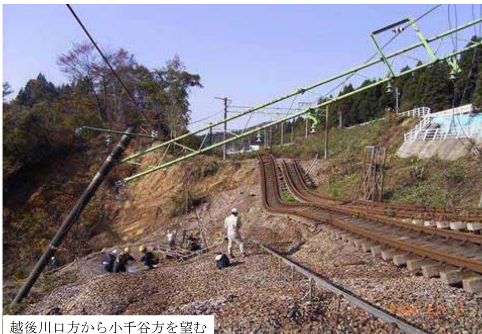
写真 1 220km900m 付近の被害状況
