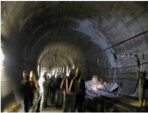
写真 1 トンネル覆工の崩落
