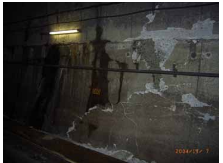
写真 4 覆工破損箇所での湧水
