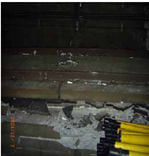
写真 3 スラブ軌道の盛り上がりと破損
