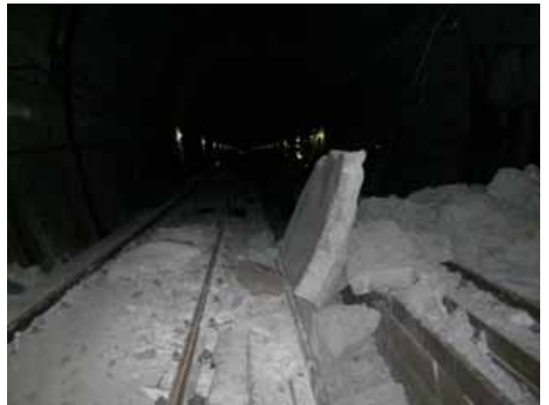
写真 2 軌道上への覆工破片の落下
