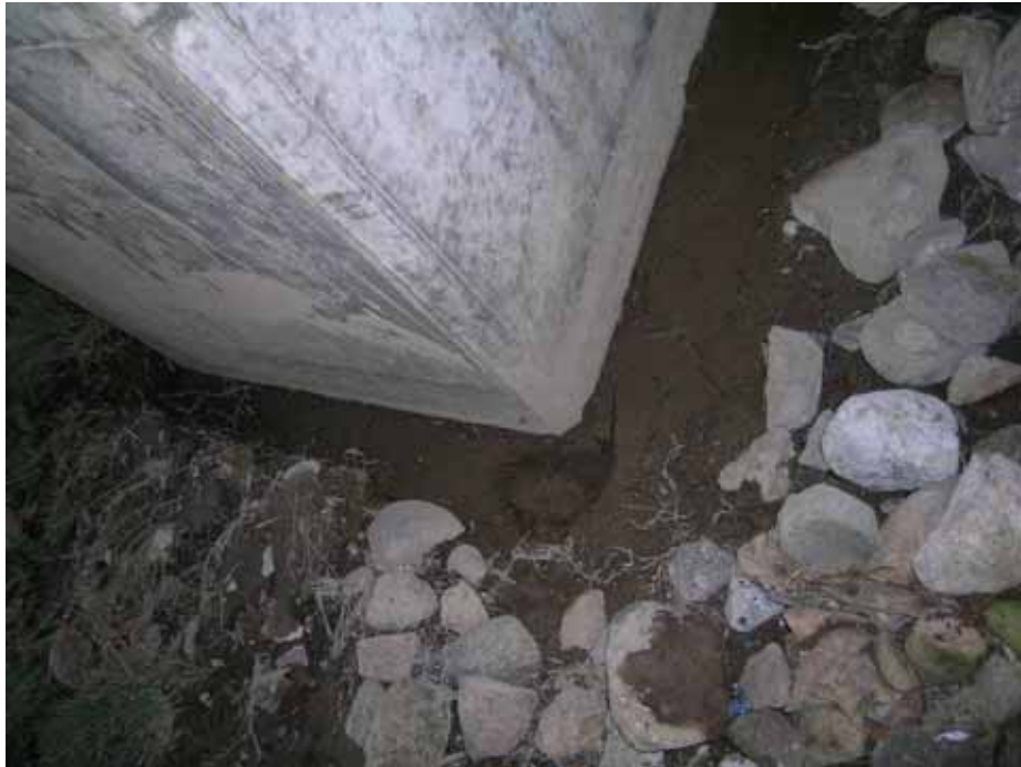
写真 4 橋脚基部における液状化痕
