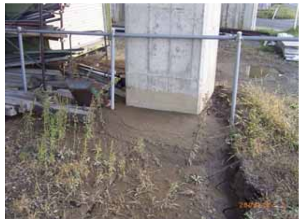
写真 3 基礎の埋め戻し部の沈下
