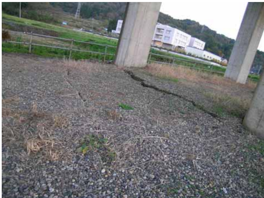
写真 5 地表面部に発生した亀裂
