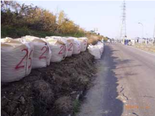
写真 1 腰土留めの転倒
