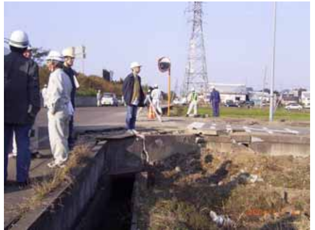
写真 2 側道脇の側溝の破損
