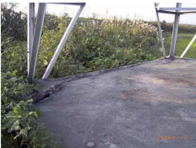
写真5 送電鉄塔基礎上板の沈下
