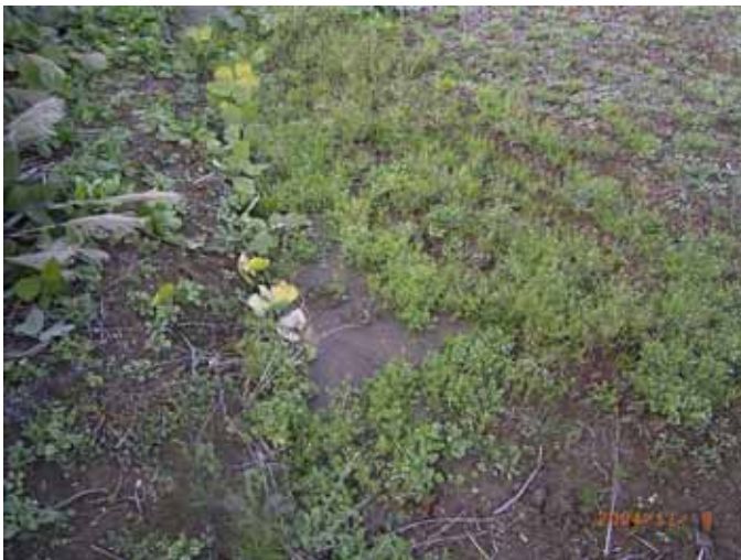
写真4 堤内地側水田に見られた噴砂
