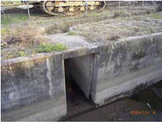
写真3 樋管への取り付け水路の変位（写真の右側が堤防側）
