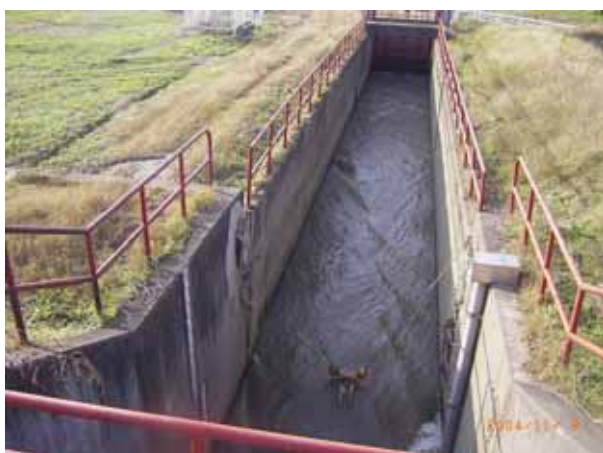
写真 3 樋門の堤内地側水路の破損
