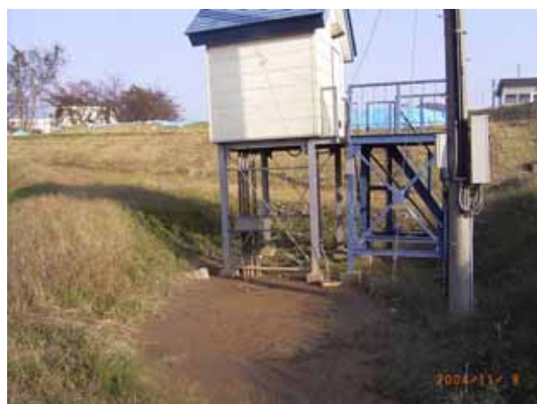
写真 3 堤内地側で見られた大規模な噴砂
