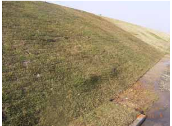
写真 2 湧水箇所でのはらみ出し(堤外地側)
