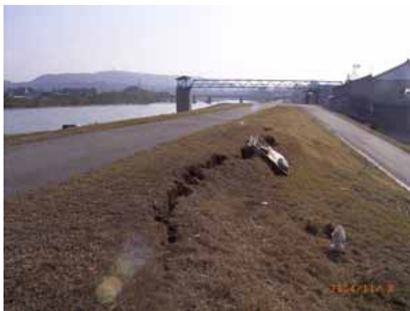
写真 3 湧水箇所でのすべり(堤内地側)
