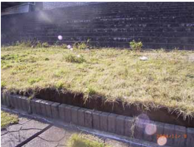
写真1 小段部で生じた段差
