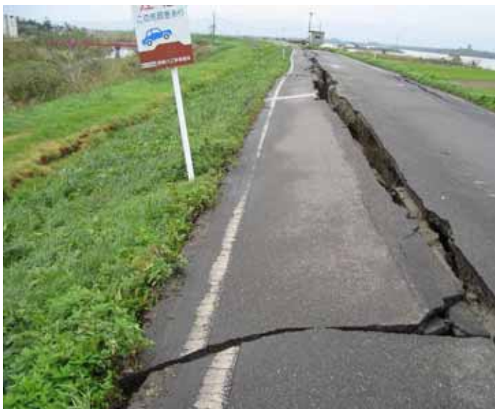
写真 1 堤防天端に生じた亀裂。右手が信濃川、左手が猿橋川。堤内側（猿橋川側）ののり面及び小段にも大きな亀裂あり。（2004年10月27日撮影）
