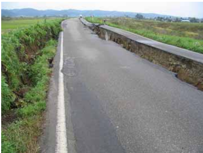
写真2 のり肩を残し天端が1m程度沈下（2004年10月27日撮影）
