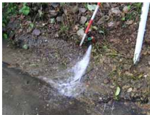
写真 4 路面への排水状況
