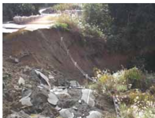
写真 2 北側の崩壊箇所（南方向を望む）
