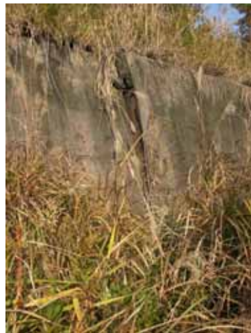
写真10 高町4丁目付近の外周擁壁の 変位
