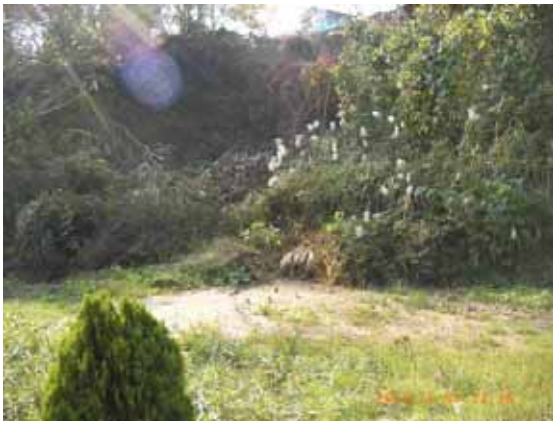
写真9 高町1丁目の被災箇所下部(背面土流出) 変位
