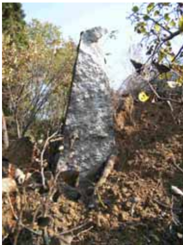
写真5 高町3丁目の被災箇所の擁壁断面
