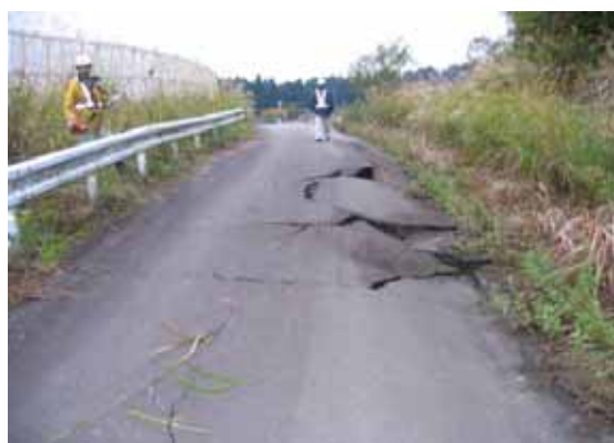
写真4 テールアルメ擁壁 A 天端のひび割れ・陥没(日本道路公団資料)
