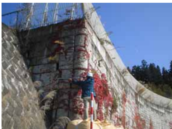
写真1 テールアルメ擁壁 A の被害状況(中段部のはらみ出し)と隣接するブロック積み擁壁の状況(無被害)
