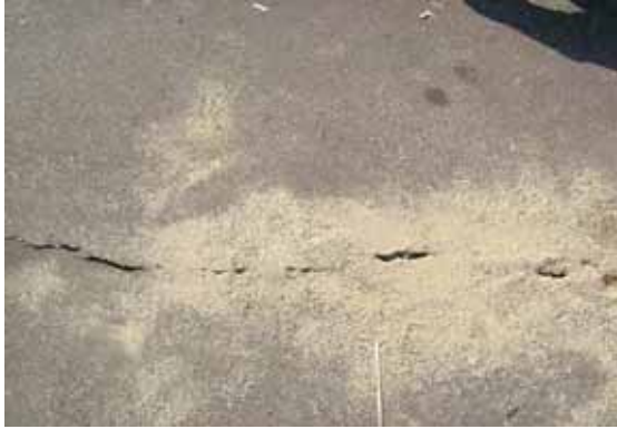
写真5 テールアルメ擁壁 A 天端での噴砂
