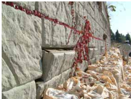
写真2 テールアルメ擁壁 A の被害状況(中段部のはらみ出し)
