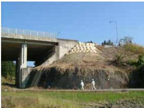
写真9 テールアルメ擁壁 C と被害状況と地山のパネル積み擁壁の縦断クラック
