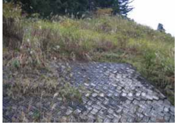
写真6 テールアルメ擁壁 A 上部斜面のパネル積み擁壁のひび割れ（日本道路公団資料）
