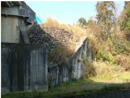
写真7 テールアルメ擁壁 B の被害状況（壁面工の傾き）
