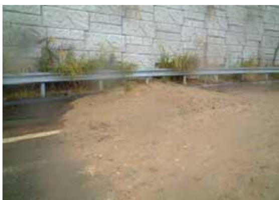
写真3 テールアルメ擁壁 A の湧水と背面土のこぼれ出し(日本道路公団資料)
