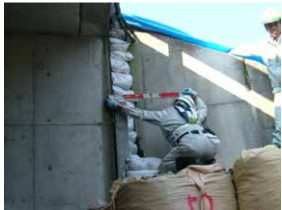
写真8 テールアルメ擁壁 C の被害状況（目地開き、背面土の流出）
