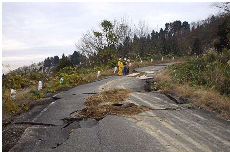
写真 3.3 木沢集落の北側、旧地すべり滑落崖上の状況：図 1 の B の亀裂。
