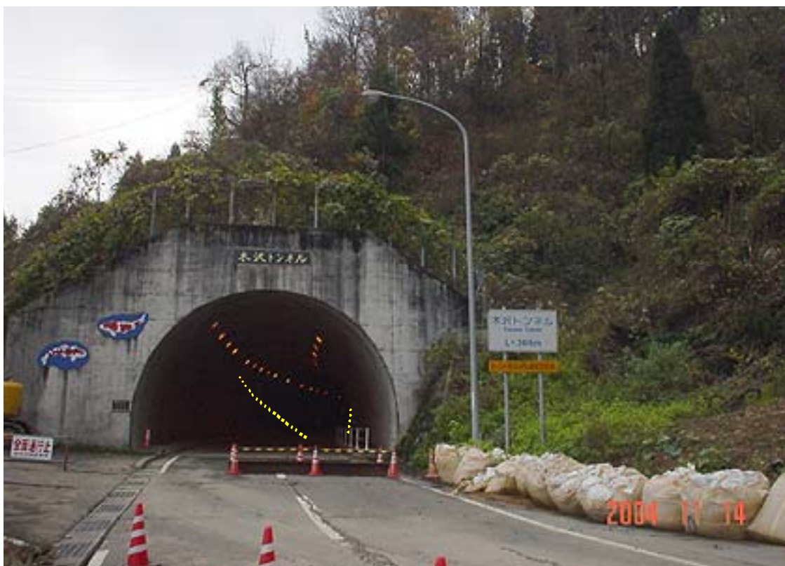
写真 3.4 木沢トンネル北側坑口：写真に付した黄色破線部に損傷が見られる。トンネル背後の樹木に被覆された尾根の後ろが写真2に対応する。
