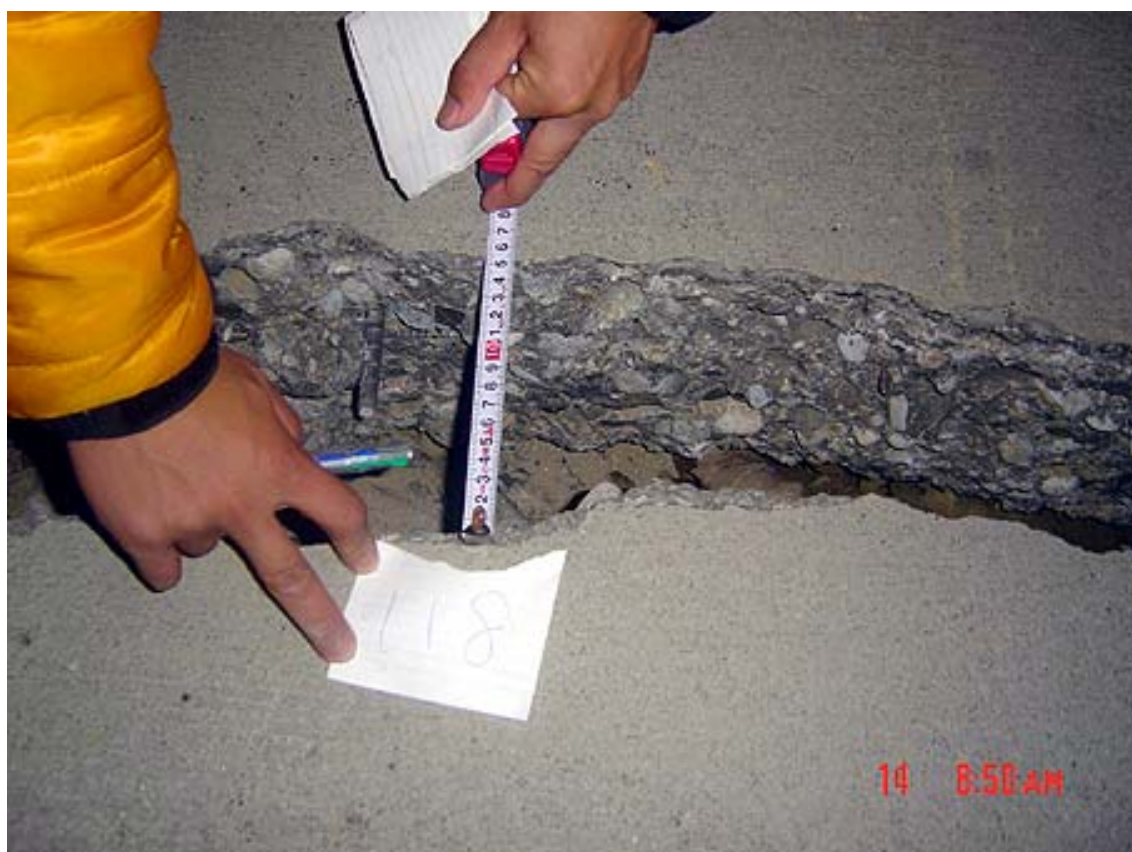
写真 3.7 木沢トンネル内床版の亀裂開口(北側坑口より 230m)
