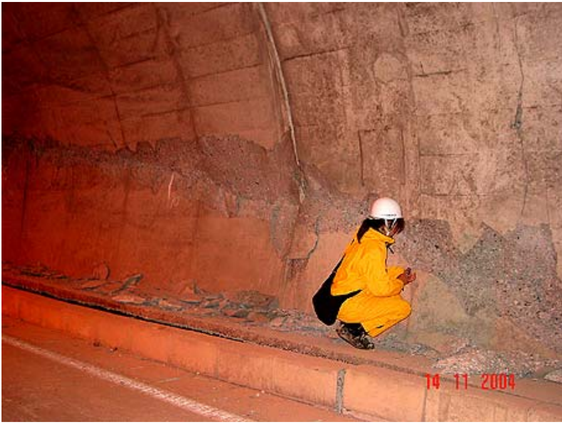
写真 3.6 東側側壁の圧壊：東側の壁は地山側に 40cm ほど押し出している。
