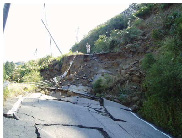
写真-12 段差が生じた道路（山古志村）
